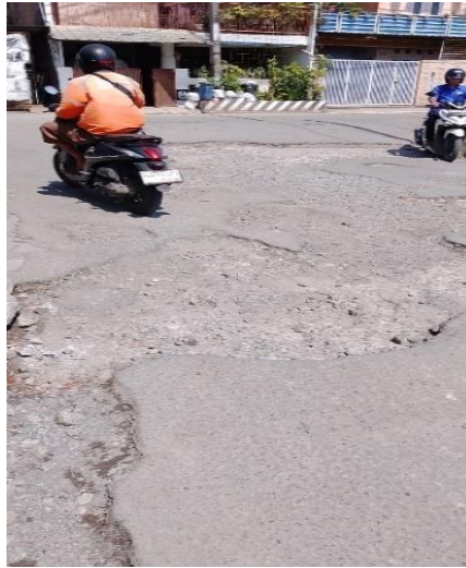
Gambar 2 Jalan Rusak di Desa Cibiru Hilir
