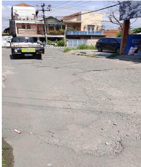
Gambar 4 Kondisi Jalan Rusak di Desa Cibiru Hilir
